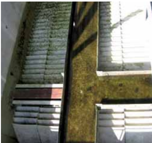
Abb. 2 Lamellenabscheider im Sedimentationsbecken
