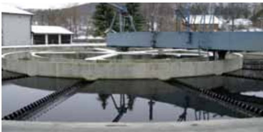
Abb. 2 Sedimentationsbecken (ehemaliger Cyclator)
